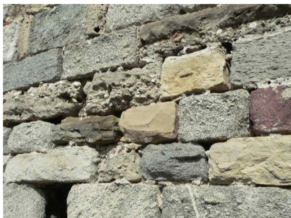
PARTICOLARE DEL DEGRADO – Lacune diffuse della malta di allettamento
