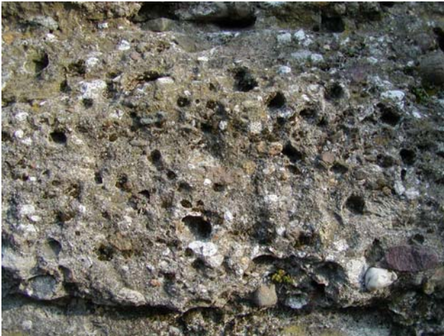
PARTICOLARE DEL DEGRADO - Caduta dei clasti
