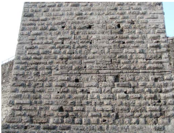
Fessure sul lato sud della Torre
