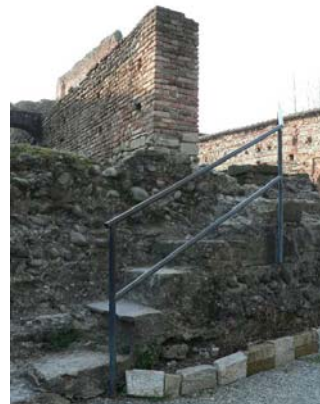
Particolare scala e parapetto non conformi alla normativa vigente
