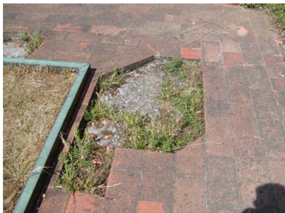
Lacune nella pavimentazione in cotto sulla sommità della Torre
