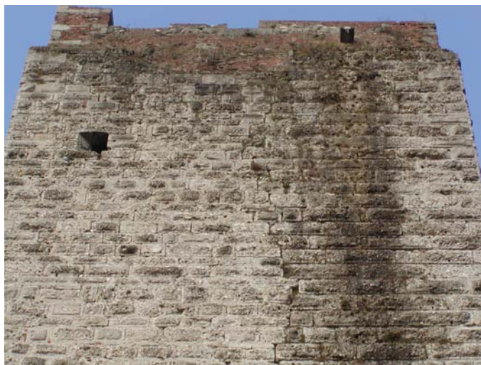
Tratto sommitale della fessura sul lato est della torre Si denota anche una ampia zona caratterizzata dalla presenza di depositi superficiali
