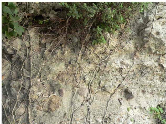
PARTICOLARE DEL DEGRADO - Infestazione da vegetazione superiore
