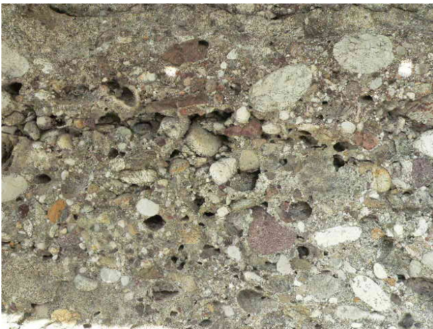
PARTICOLARE DEL DEGRADO - Disgregazione ed erosione del Ceppo d'Adda
