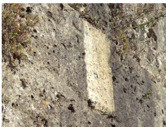
PARTICOLARE DEL DEGRADO – Depositi pulverulenti e infestazione da vegetazione superiore
