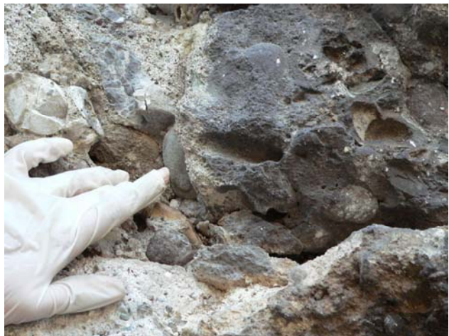
PARTICOLARE DEL DEGRADO - Crosta nera
