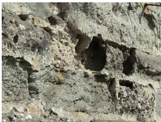
PARTICOLARE DEL DEGRADO – Erosione profonda degli elementi lapidei
