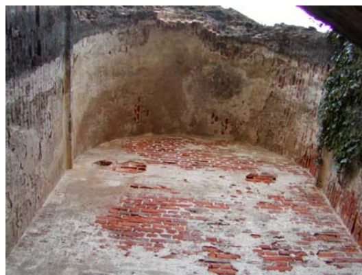
PARTICOLARE DEL DEGRADO – Lacerti di intonaco mancanti e distaccati
