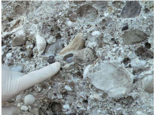
PARTICOLARE DEL DEGRADO - Caduta dei clasti
