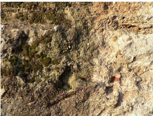
PARTICOLARE DEL DEGRADO - Infestazione da patina biologica
