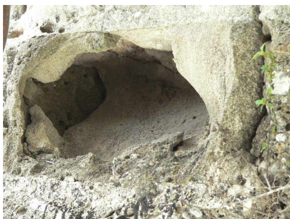
PARTICOLARE DEL DEGRADO – Lacune e mancanze profonde nella tessitura muraria
